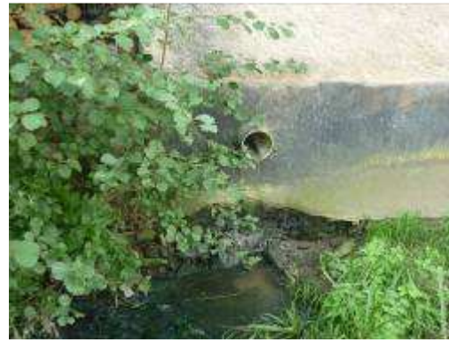
Ph 31 : Rejet domestique (RD)
