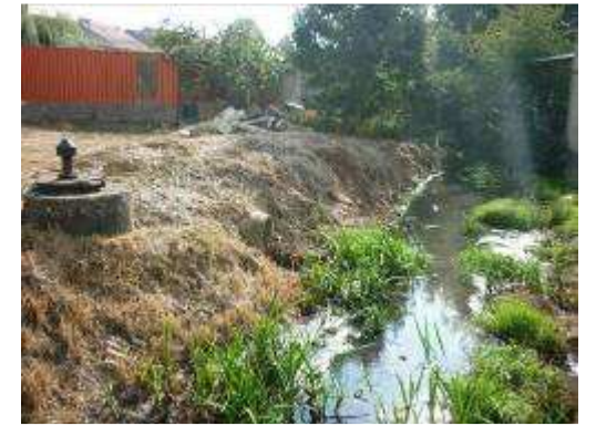
Ph 29 : Vue en aval du pont (Eau stagnante / Odeurs / De nombreux rejets domestiques=)
