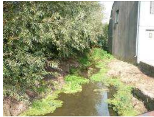
Ph 27 : Vue en amont immédiat du pont (zone élargie / développement de végétation / Eau stagnante)
